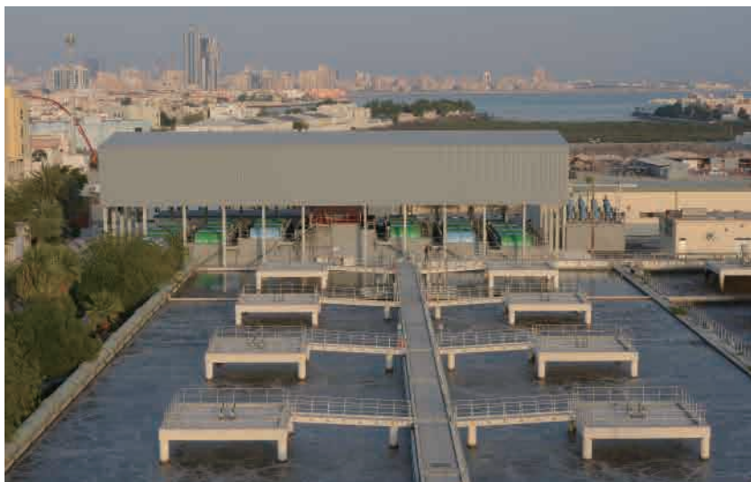
照片显示了曝气池前端的SMART™装置。
