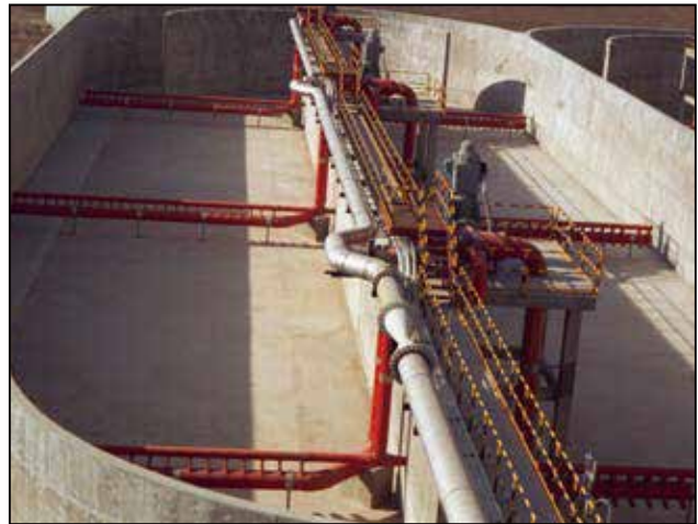
上图中的MTS射流曝气系统安装于墨西哥城的北部的一个纺织厂中，其BOD去除率要求35吨/天
